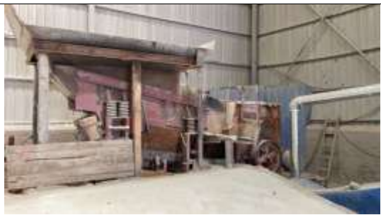
破碎机及集气管道
