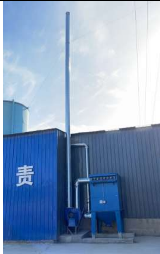
配料系统除尘器及排气筒
