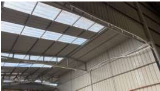
喷淋抑尘装置
