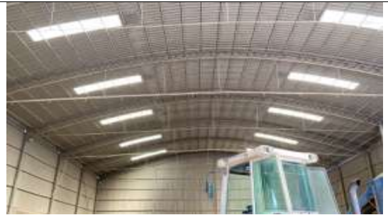
喷淋抑尘装置
