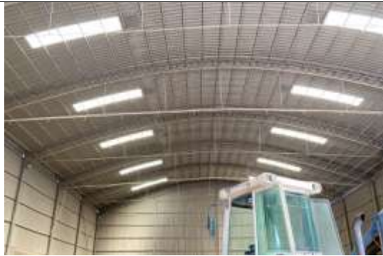
厂房内部及喷淋装置
